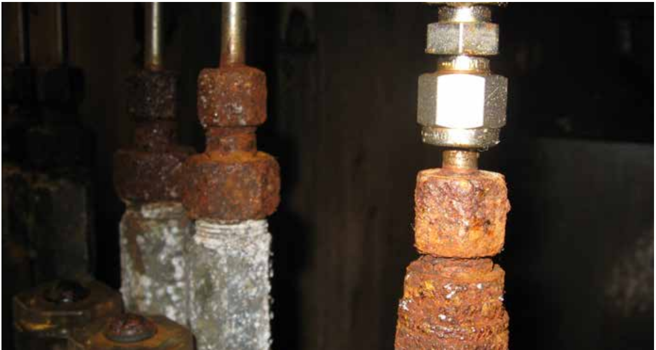
Réaction galvanique créée par des écrous et des tubes en matériaux différents.
